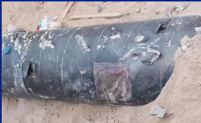
НК «Роснефть» Самара Коррозионный участок размером 350 x 280 x 35 мм
